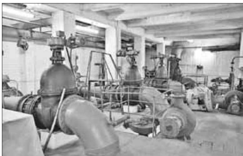
■ Насосная станция позволяет избежать затопления улиц
